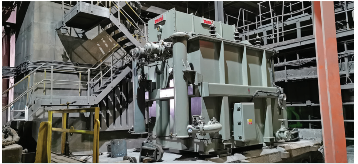
Trafo zložené na vagóne koľaje číslo 6 pripravené na transport do revíznej veže.
