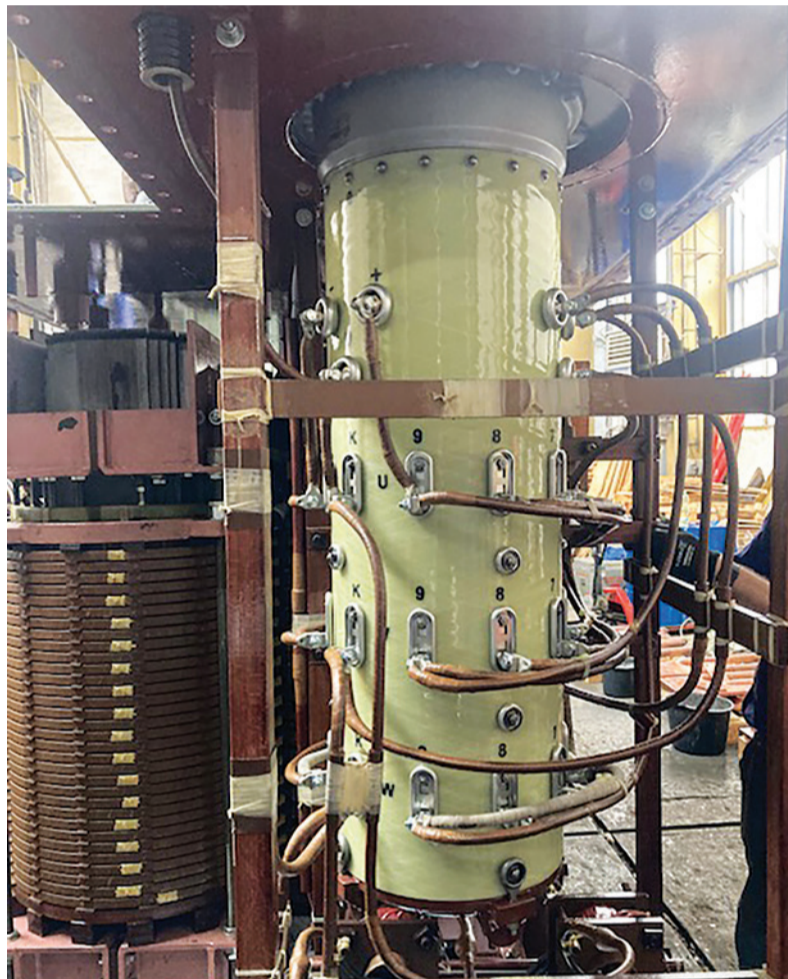
Detail z revízie transformátora.
