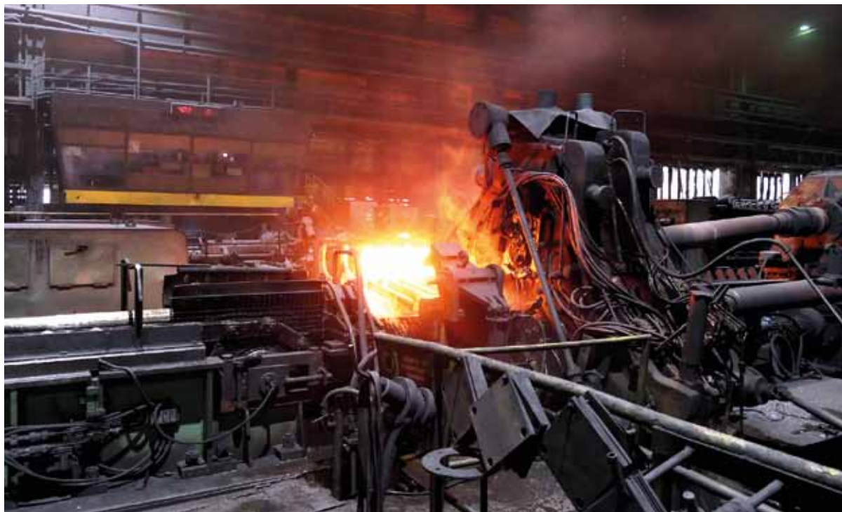
Zariadenie zvané elongátor nachádzajúce sa vo valcovni bezšvíkových rúr v novom závode.
