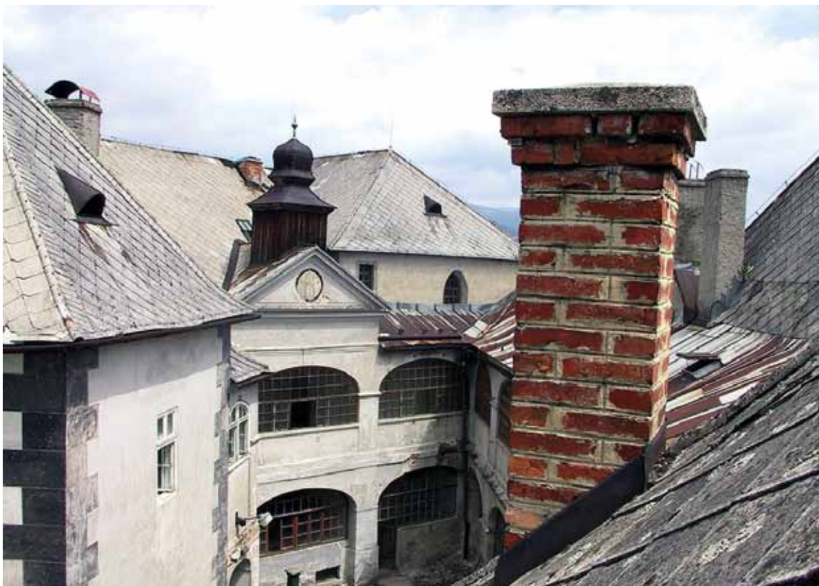
Pôvodná azbestová strecha bola pred obnovou v havarijnom stave.
