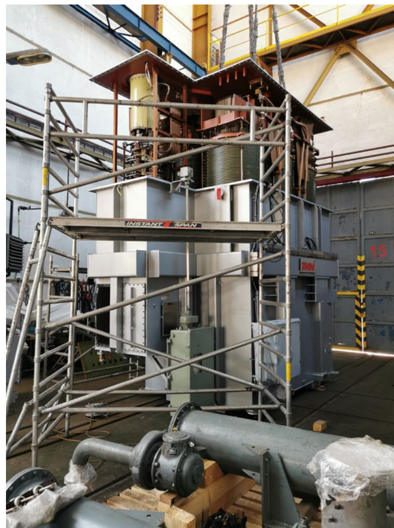
Revízia prepínačov odbočiek na pecnom transformátore EAF 50MVA.
