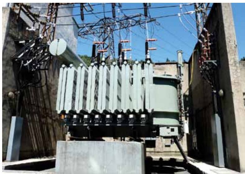
Stanovište transformátora T 102 na Planieri
