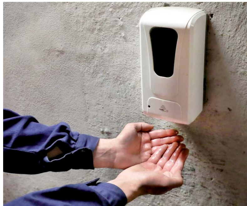
Pred vstupom do velínu si pracovníci oceliarne dezinfikujú ruky. Tento úkon sa stal za ostatné mesiace v našej spoločnosti už zaužívanou samozrejmosťou na všetkých pracoviskách. Foto: A. Nociarová
