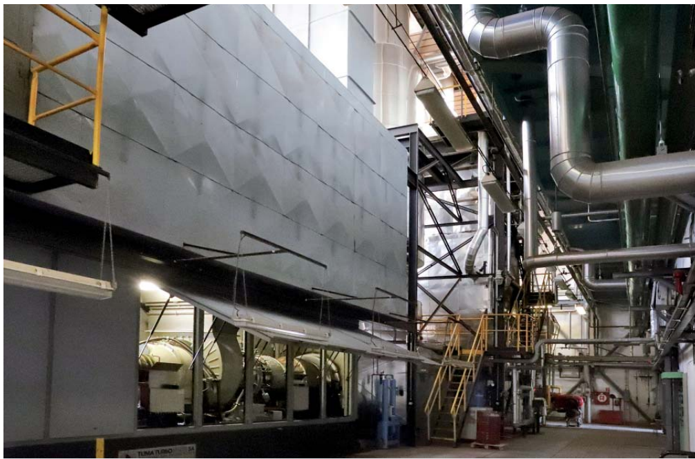
Pohľad na spaľovaciu turbínu kogeneračnej jednotky s otvorenými dverami turbosetu, v pozadí spalínový kotol kogeneračnej jednotky. Foto: A. Nociarová
