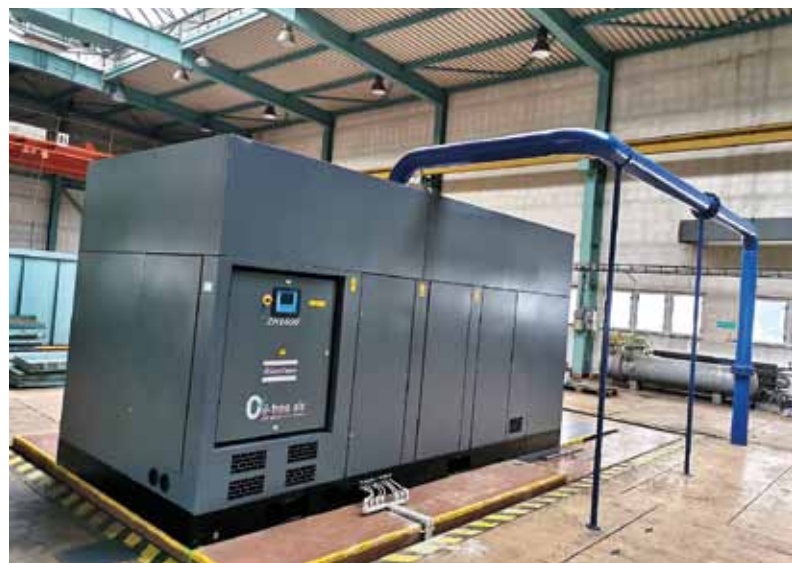
Nový kompresor Atlas Copco v kompresorovej stanici nového závodu
