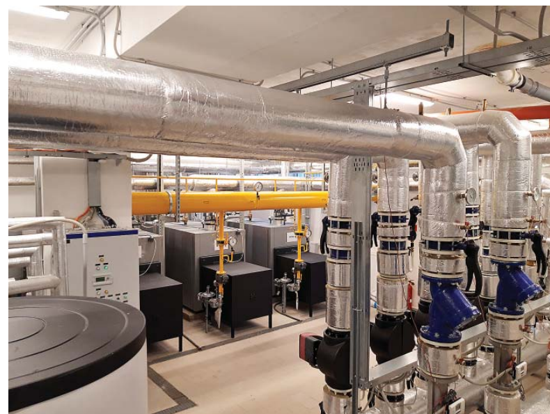
Nová nemocničná kotelňa.
