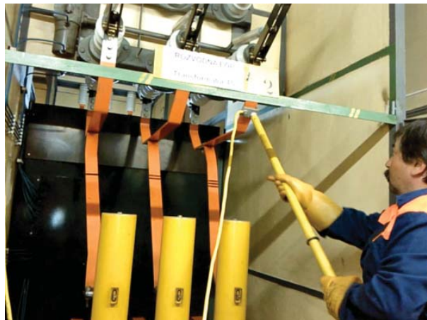
Rozvodňa vysokého napätia starý závod
