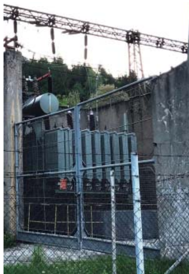
Transformátor 110 kV / 6 kV starý závod
