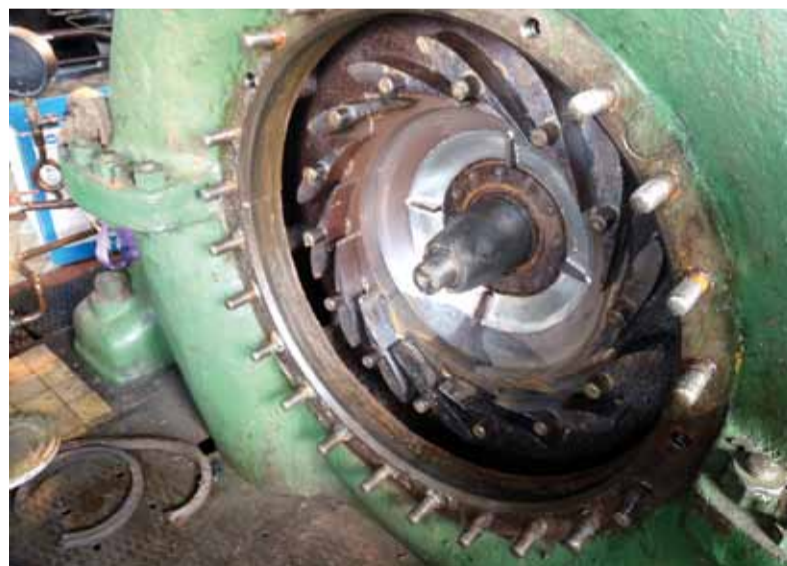
HC Piesok – kontrola rozvádzacích lopatiek v turbíne
