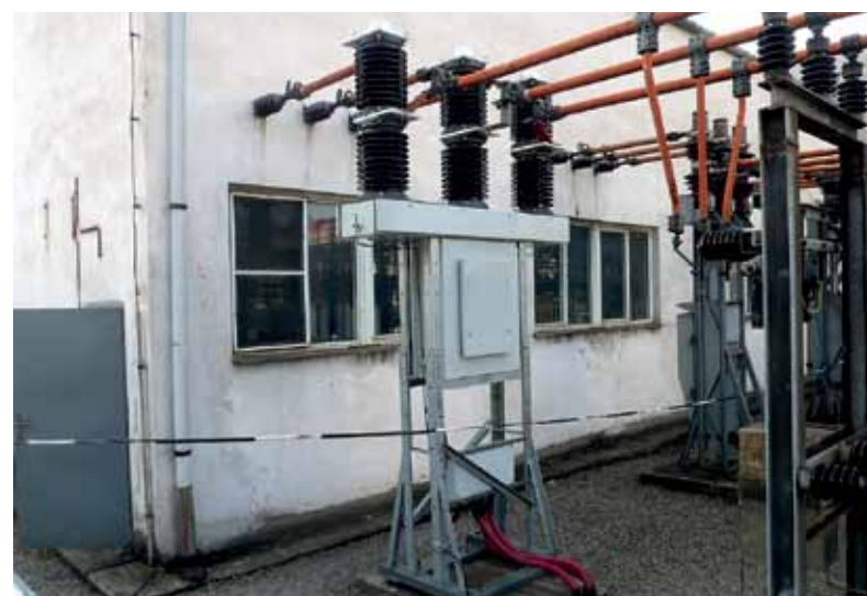
Nový vypínač filtra druhej harmonickkej kompenzácie 90 MVAR
