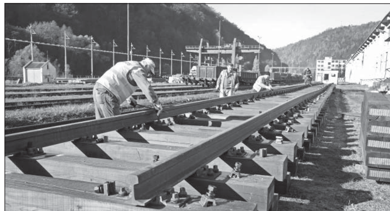
Práce na montážnom poli koľajovej dopravy v starom závode, kde boli v predpríprave kompletizované podvaly so železničnými koľajnicami. Foto: A. Nociarová
