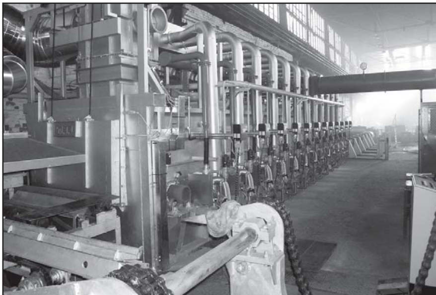
Novorekonštruovaná pec je v súčasnosti v skúšobnej prevádzke
