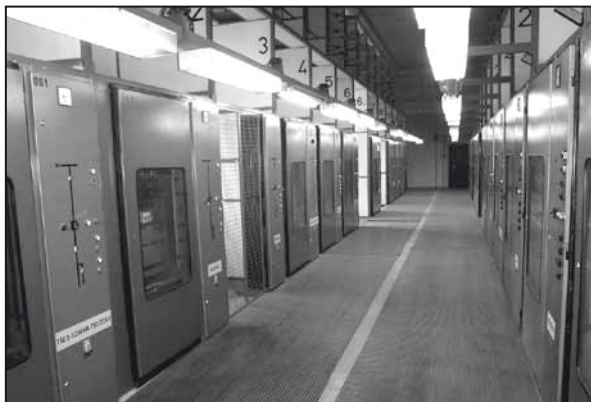
Revízie elektrických zariadení a rozvodov všetkých objektov Železiarní Podbrezová v areáli starého závodu, ktoré sa uskutočnili 1. mája 2011, prebehli v súlade s plánovaným harmonogramom a po zapnutí elektrickej energie všetky zariadenia nabehli bez problémov. Skutočnosť, že naši informatici nezaznamenali poškodenie žiadneho IT zariadenia svedčí jednak o korektnom prístupe užívateľov, ale predovšetkým o súčinnosti spolupráce energetikov a informatikov. Na snímke J. Vašša pohľad zo zariadenia 22 kV vstupnej rozvodne pre starý závod na Dolnom Planieri.
