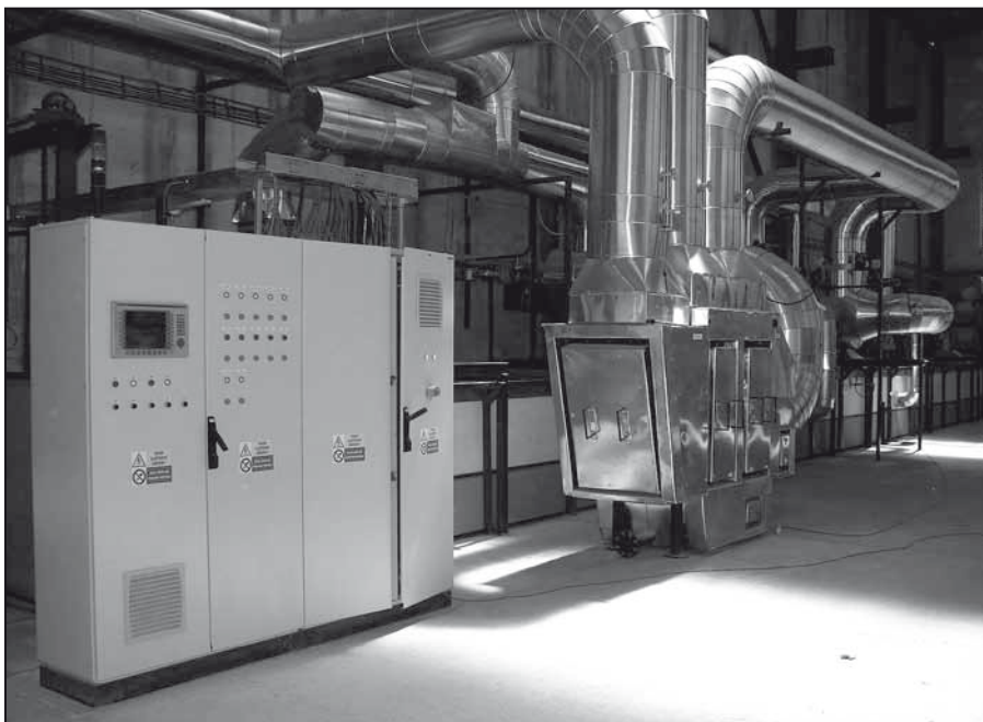
Technologická linka MgO-C stavív.
